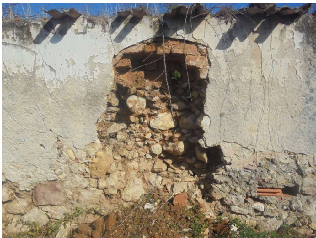
Foto 2 – Vista de pormenor da parede com colapso parcial, onde também se visualizam as telhas soltas no beirado
