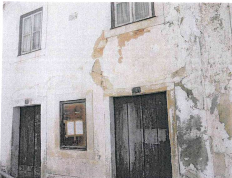
Foto 2 – Vista de pormenor da fachada onde é possível visualizar algumas das anomalias identificadas no ponto 1.1
