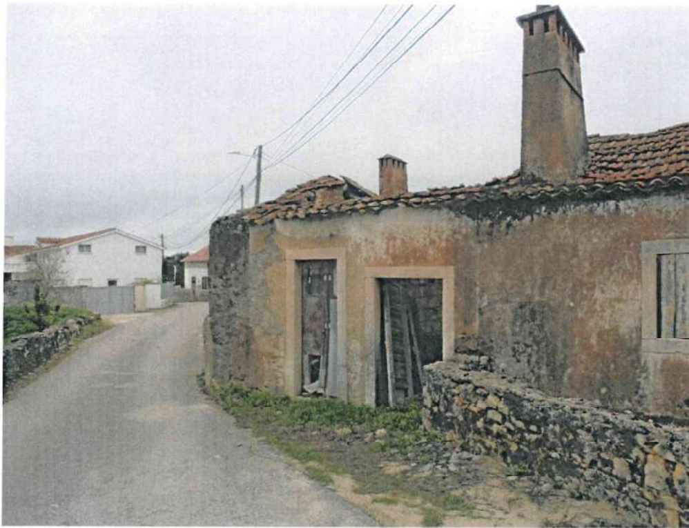
Foto 1 – Vista geral da edificação, podendo verificar-se a ausência parcial da cobertura.
